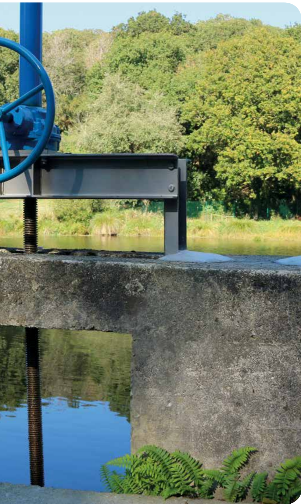
Vanne de la retenue de Banniguel à Kernilis (Finistère) Photo Syndicat Mixte Des Eaux Du Bas Léon.
