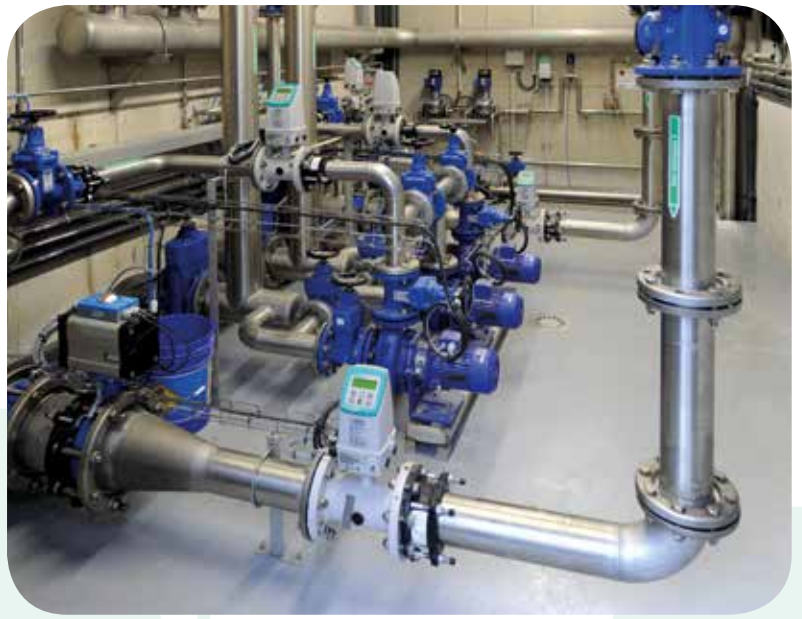
Salle des pompes de l'usine de Poraon à Crozon (Finistère) – Photo Communauté de communes de la presqu'île de Crozon – Aulne maritime.
