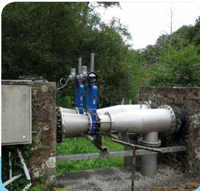
Sortie d'eau traitée de l'usine de traitement de la Roche à Mézières sur Couesnon (Ille et Vilaine) – Photo ARS Bretagne.
